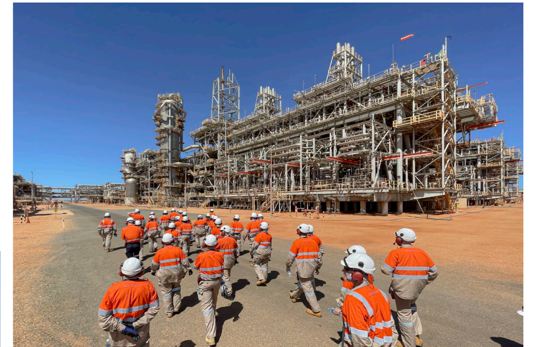
Gorgon LNG facility, WA. Image courtesy of Chevron.
